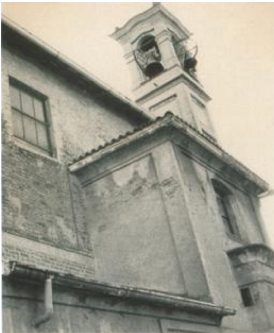
Immagini del degrado interno
