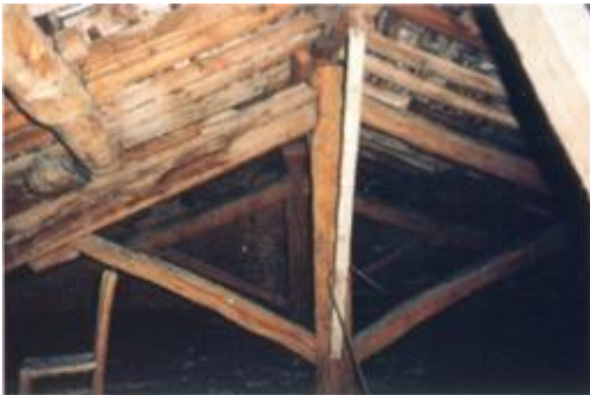
Degrado delle pareti interne
